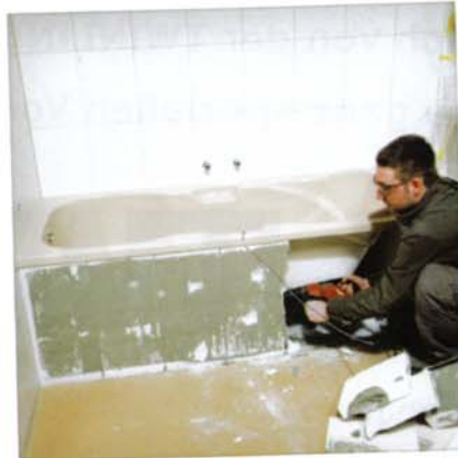
10:15 DIE WANNENVERKLEIDUNG, + EINE REIHE FLIESEN KOMMT RUNTER
